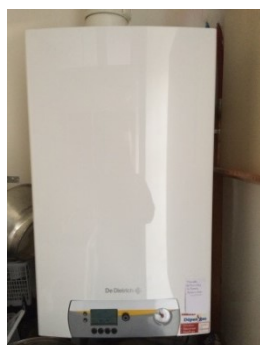
Chaudière à condensation gaz Octobre 2014
