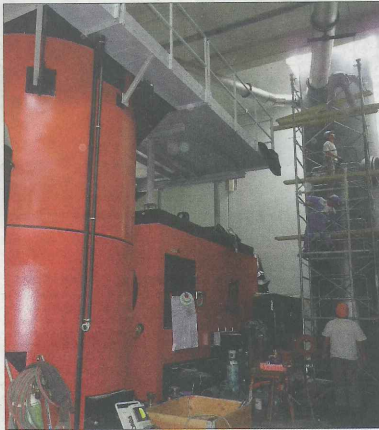
La grosse chaudière à bois et la base de la cheminée sur laquelle travaillent les ouvriers. 5 700 tonnes de bois seront avalées chaque année.
