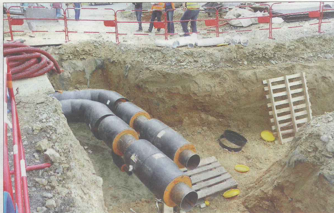
Les tuyaux en acier pré-isolés au départ de la chaufferie. Ils alimenteront en eau chauffée les 33 sous-stations où se feront les échanges calorifiques.
