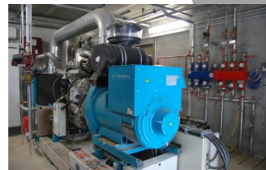
Module de cogénération GAEC Lejeanne Moussonvilliers - 61
